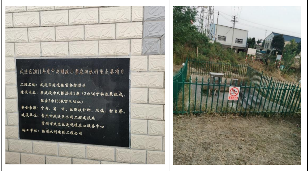
图 2.5-7 前杨泵站现场照片
