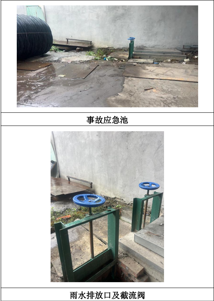
图 3.3-1 事故应急池、雨水排放口及截流阀现状情况
